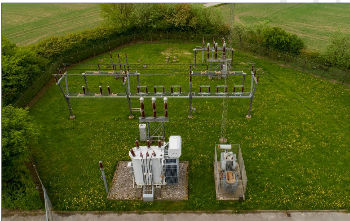
Eksempel på hvordan et udendørs 60 kV anlæg med kabelfelter ser ud.
